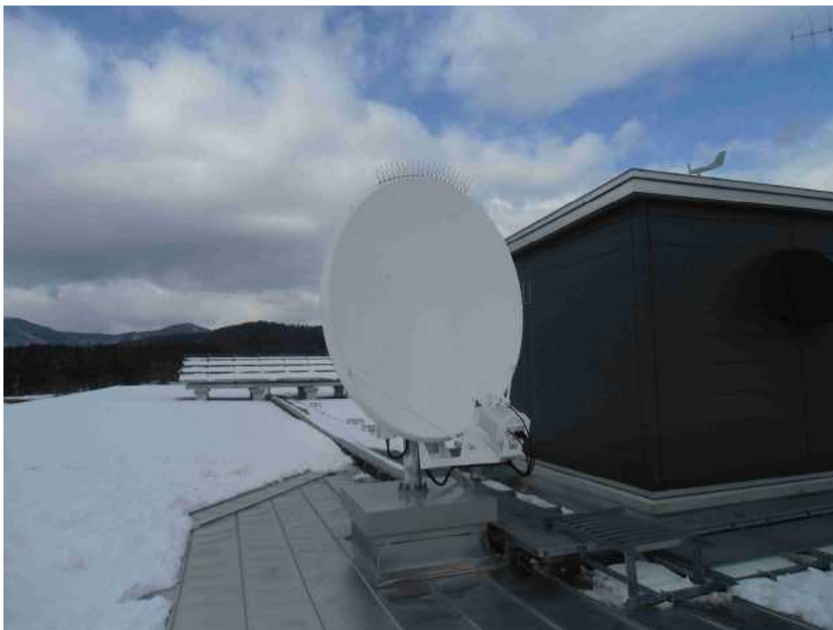
岩手県防災システム アンテナ設置事例写真
